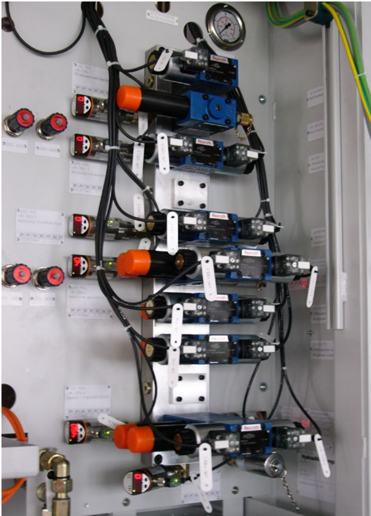
Abb. 20 Kennzeichnung von Hydraulikventilblöcken
