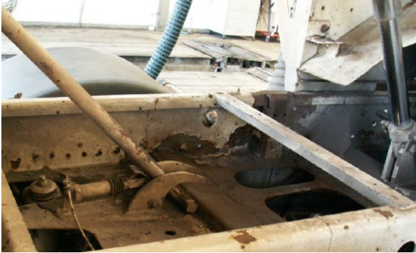
Abb. 37 Sicherungsstütze an einem hydraulisch angehobenen Fahrzeugaufbau
