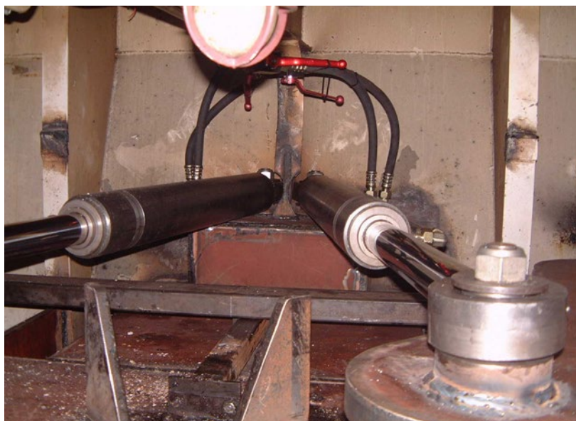
Abb. 43 Quetschgefahren an einer Ruderanlage
